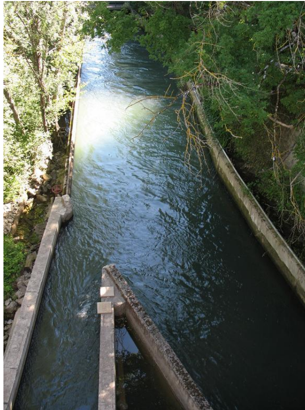
Figura 54-11. Canal de derivación de caudales aguas arriba de Jaca.
