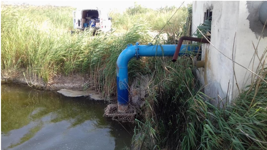
Toma de agua para riego
