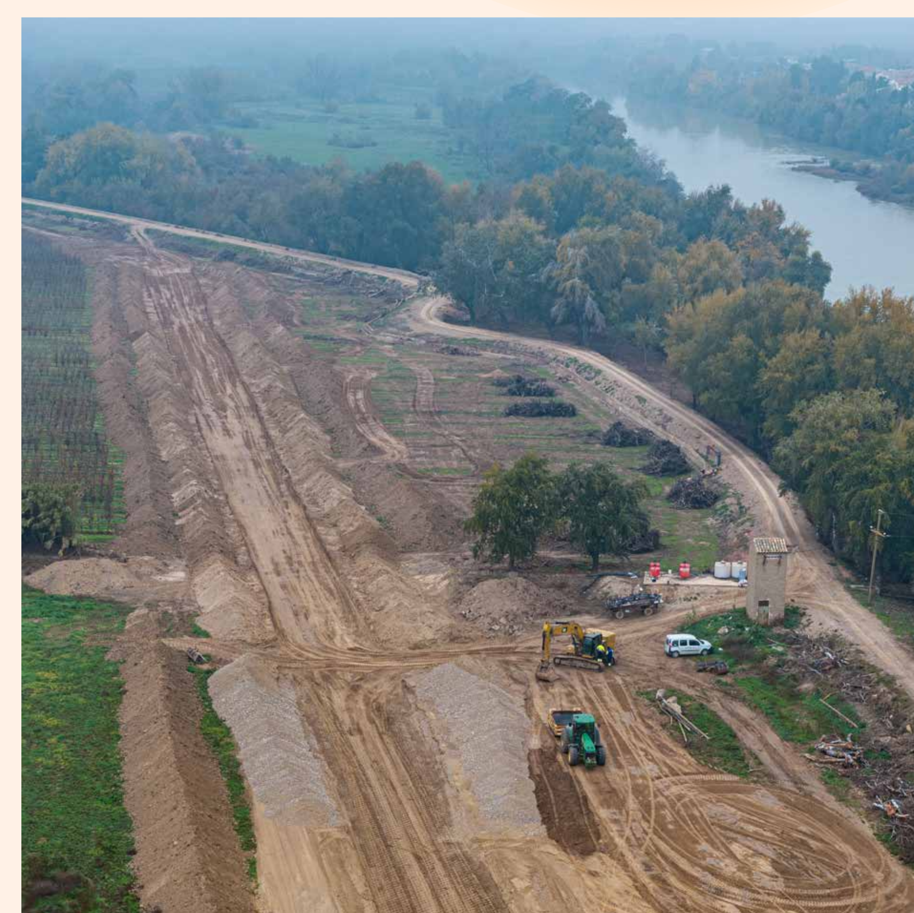
Retranqueo de motas el tramo del río Ebro entre Osera de Ebro y Fuentes de Ebro (Zaragoza).
